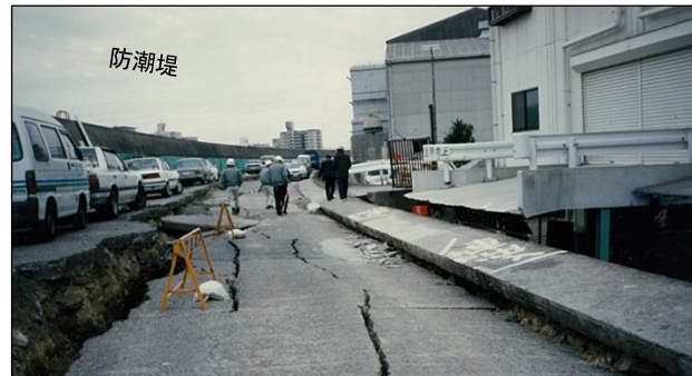
写真 2.7 神崎川右岸堤防（佃地区）の被災状況 （大阪府西大阪治水事務所提供）
