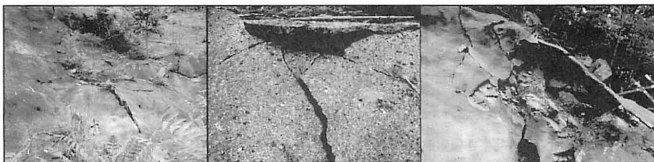
はらみ出しによるモルタルの亀裂
