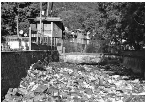
写真12 カパシアン市街のゴミ溜化した都市河川
