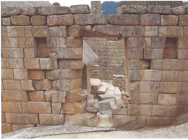
Fig. 7 北側開口部の著しい劣化
