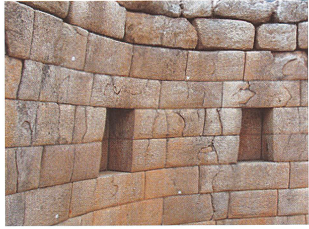
Fig. 8 表層部の亀裂と剥離
