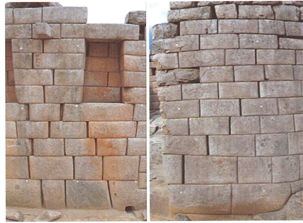
Fig. 10 石材接触面の隙間の拡大
