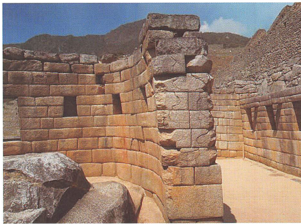
Fig. 9 石積壁端部における欠損
