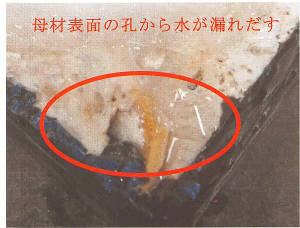
Fig. 13 水漏れの状況
