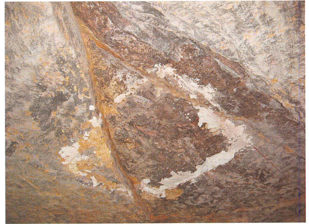
Photo 4 天井ブロック B の亀裂
