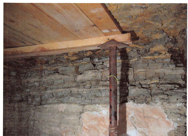
Photo 2 壁上部の泥灰岩層の劣化
