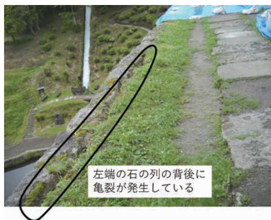
写真3 地震により生じた地表面の亀裂
