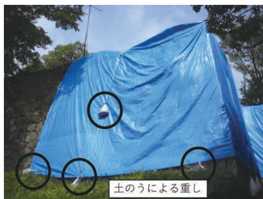
写真2 熊本地震で被災した城郭の一部
