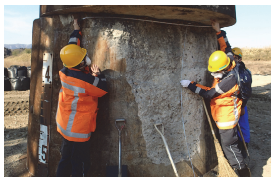
(b) 打継目下部の剥落
