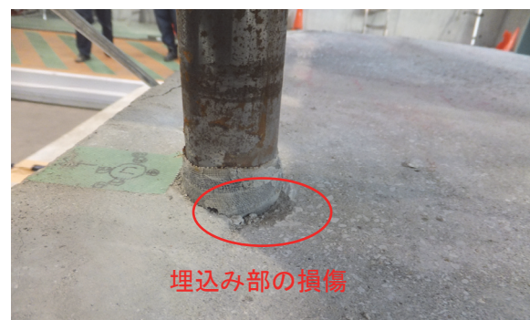
図 5.39 鋼棒付近の圧縮応力による損傷状況
