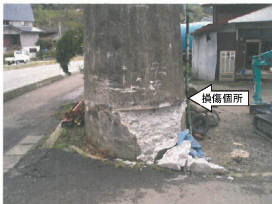
図 4.7 貫通ひび割れおよび打継目下部コンクリートの剥落(17P) 9) に加筆
