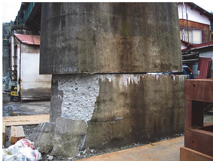
図 1.1 地震により被災した無筋橋脚 1)
