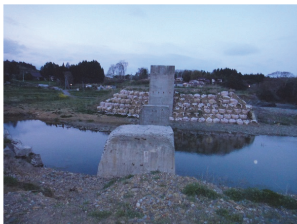
図 4.12 津波により折損した無筋橋脚
