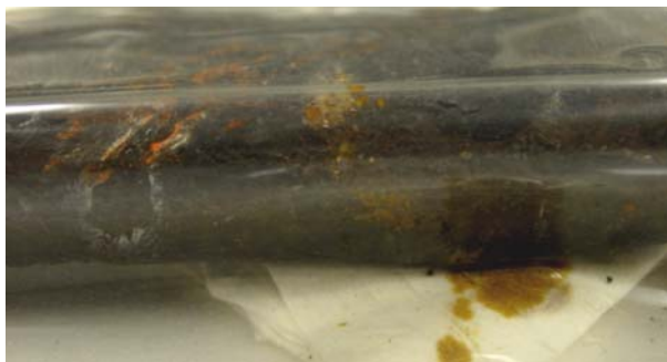
写真26 錆汁の発生状況
