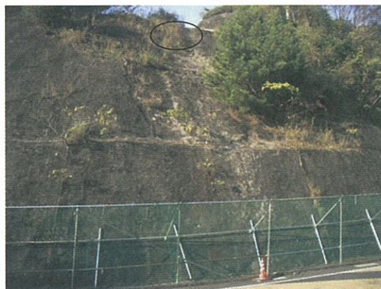
写真-6 法面内でプラス値を示す位置
