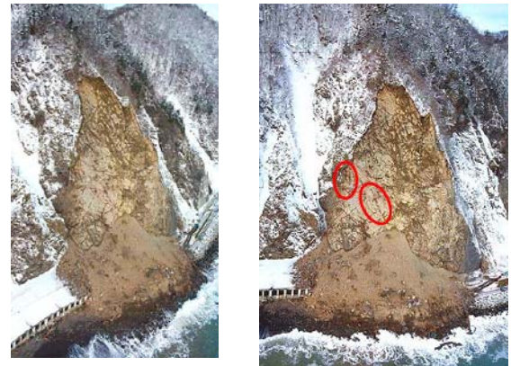
(a) えりも側 (b) 正面 図-4 崩壊状況 (平成 16 年 1 月 15 日撮影)
